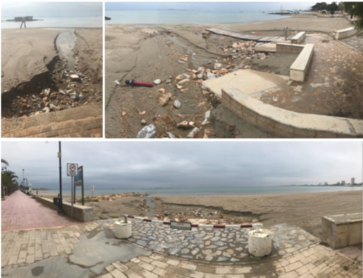
Figura 4.5: Cárcavas causadas por el paso del agua en diferentes puntos entre la playa de Lo Pagán y las de Santiago de la Ribera tras las lluvias torrenciales de marzo de 2020. Las cárcavas formadas tras las lluvias de septiembre de 2019 - enero de 2020 fueron observadas en los mismos puntos. Éstas fueron restauradas en febrero de 2020 y volvieron a formarse tras las lluvias de marzo, lo que obligó a restaurar de nuevo la playa, aunque en esta ocasión sin aportar arena externa, sino mediante redistribución de la arena de playa seca.
